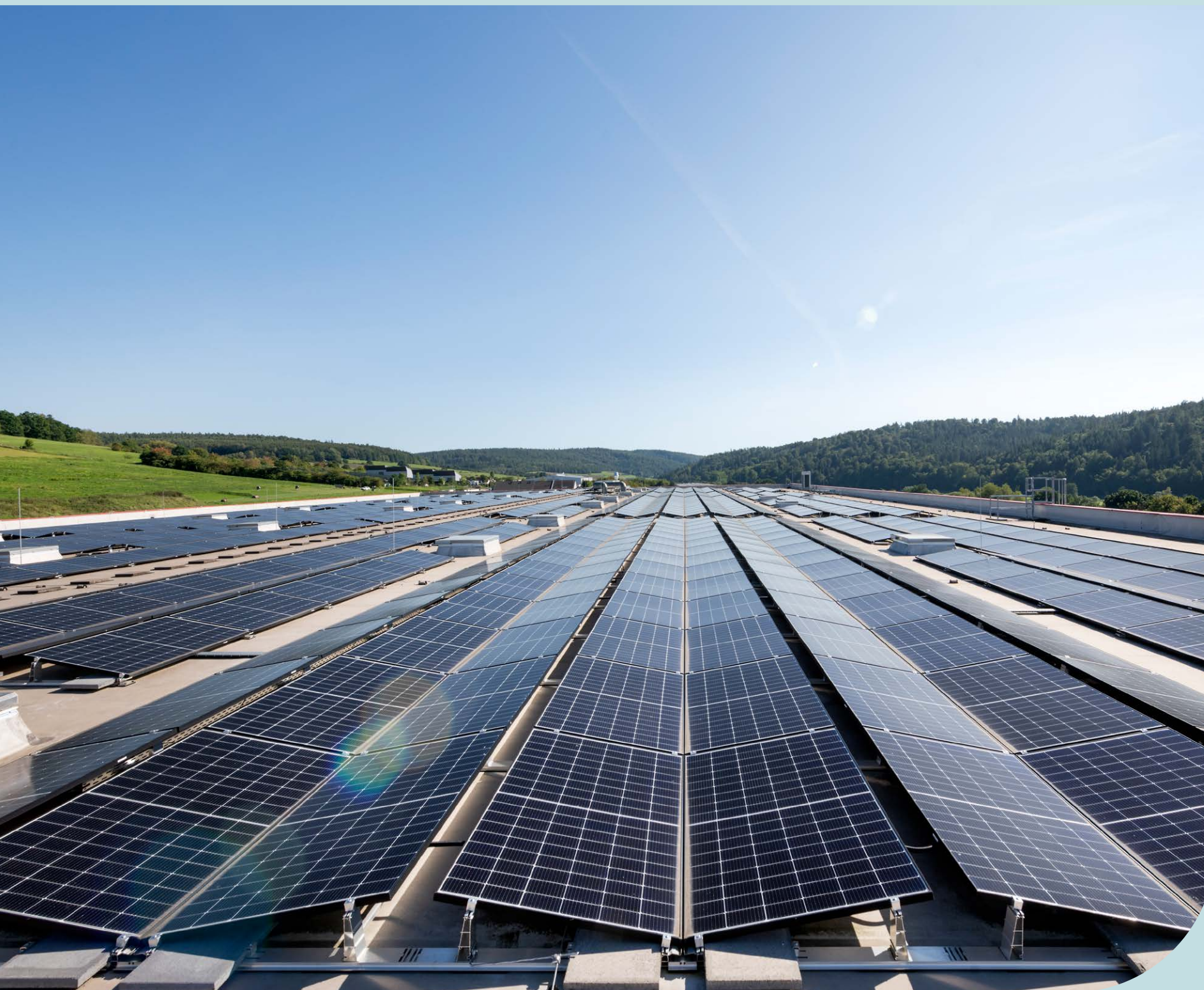
Die mit Solarpaneelen erzeugte Energie auf dem Logistikobjekt in Schlitz versorgt den Mieter mit Strom.
